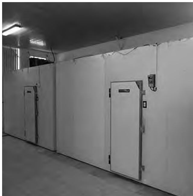
Cámaras frigoríficas en la Casa Central de General Pico.
